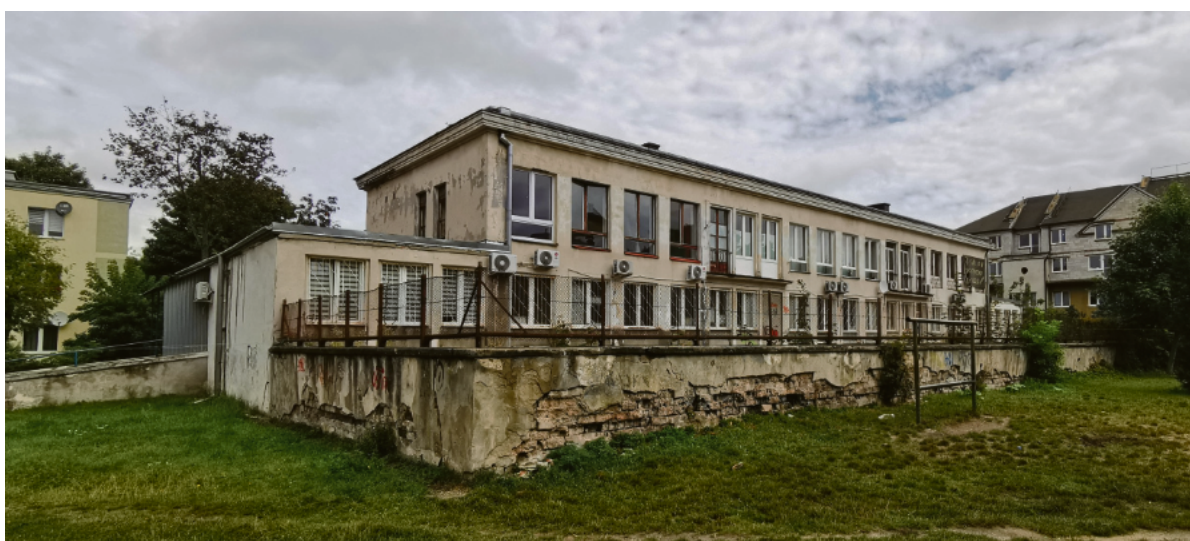
Gruntownej modernizacji wymaga budynek dawnego żłobka na ul. Sikorskiego 11. fot. Grzegorz Żak
